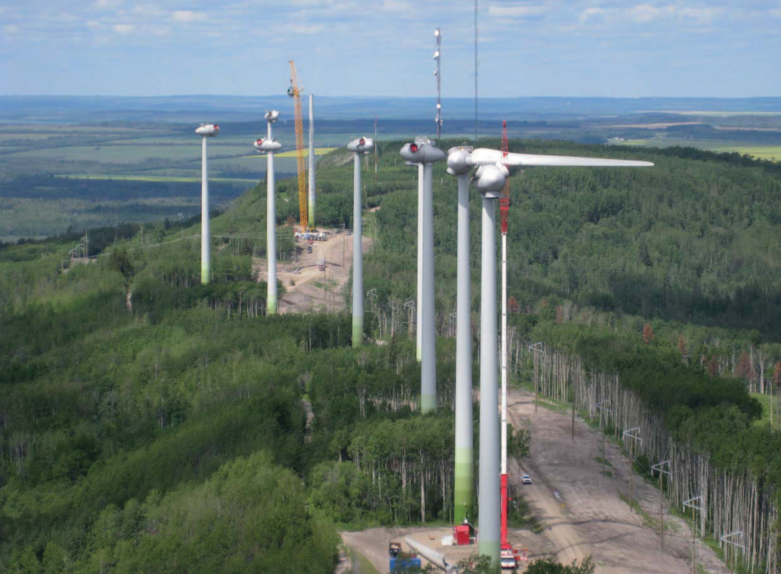
Une grue mobile télescopique de 250 t aide au montage pale par pale (en avant plan), pendant qu'une grue sur chenilles traditionnelle soulève la nacelle.
